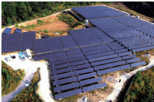
エスケーアイ岡崎発電所
